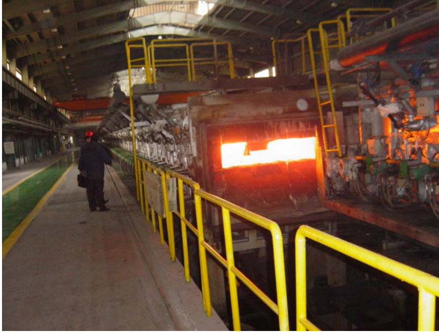
CSP 加热炉烧嘴在马钢 CSP 生产现场
