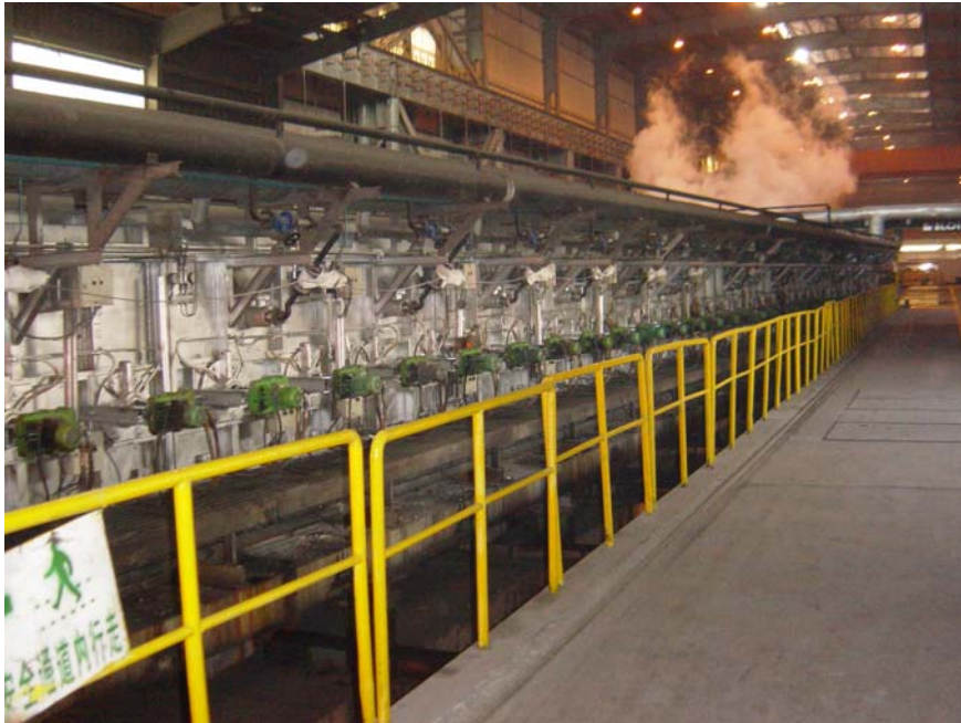
CSP 加热炉烧嘴在包钢 CSP 生产现场
